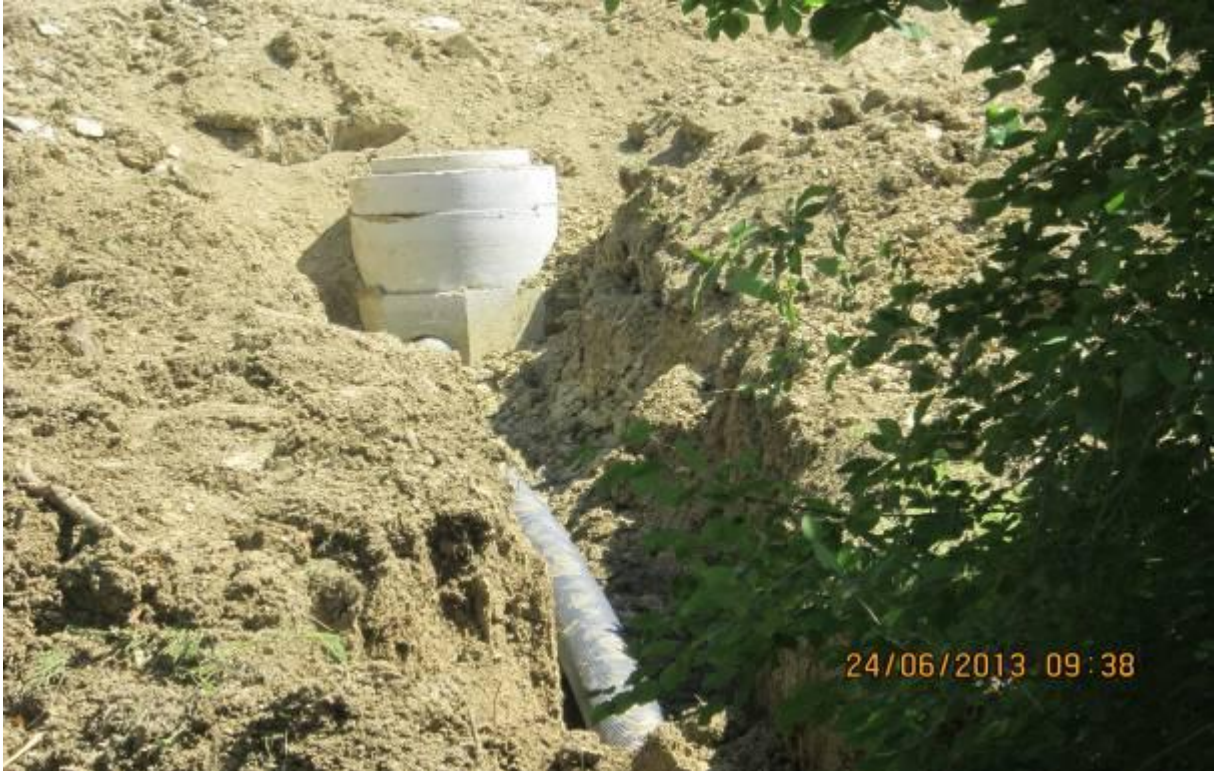
BAŞSÖKÜ KÖYÜ KANALİZASYON BACASI
